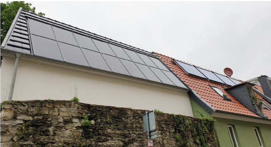
Abb. 5: Dachintegrierte PV-Anlage (links) und Solarthermie-Anlage (rechts) auf den Stiftungsgebäuden Foto: Nina Kreuzadler
