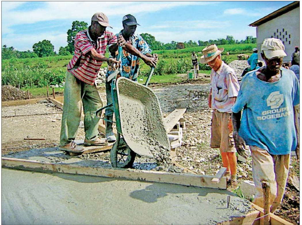
Ein Jahr nach dem Erdbeben sind die Bauarbeiten für das Berufsschulzentrum in Léogâne in Haiti in vollem Gange. Die Biohaus-Stiftung von Willi Ernst (kl. Bild) kümmert sich dort um die Ausbildung im Solarbereich. Fotos: privat
